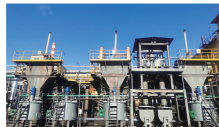
> 焦油渣离心分离装置在朝阳钢铁焦化厂投产
